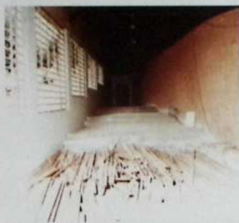
Em construção, o corredor esquerdo do prédio, partindo do salão nobre, e uma das entradas para o Cine Teatro. Esta é a parte que até hoje apresenta a maior infiltração de águas das chuvas.
